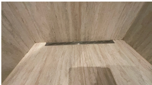
Rennesluk i dusjsonen.
