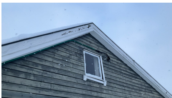
Vindskier bærer preg av elde og slitasje.
