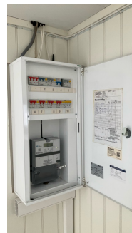
Sikringsskap plassert i soverom i 1. etasje.
