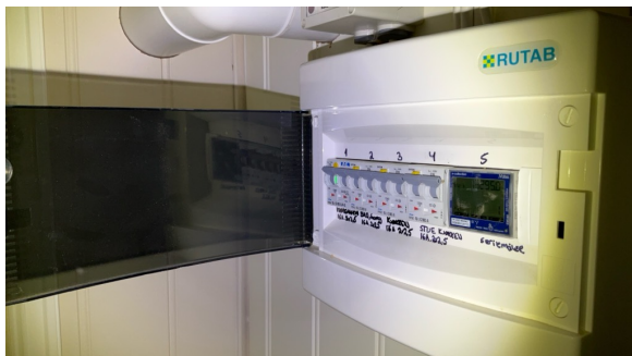
Sikringsskap plassert i gang i kjeller.
