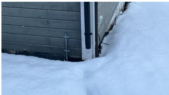
Takvannet ledes ikke vekk fra bygningen.
