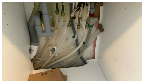
Vannrør er ikke lagt vannskadesikkert.
