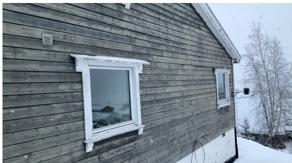
Kledning bærer preg av slitasje.
