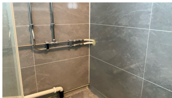
Rørgjennomføring i dusjsone er en risikoløsning.
